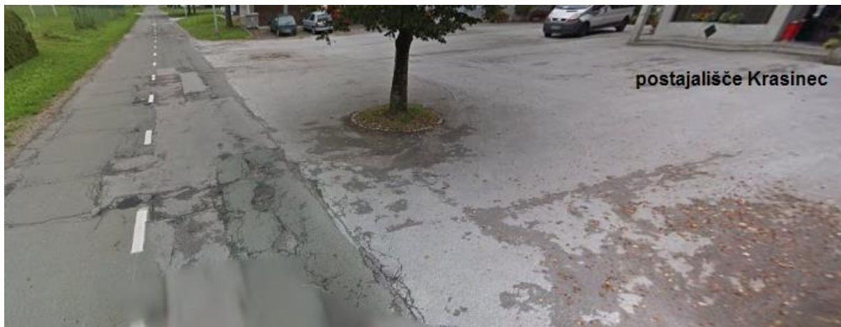
Slika 10: Nevaren odsek Krasinec
